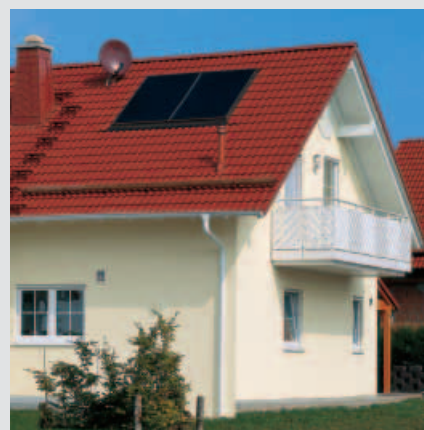
Fig. 16: Capteur solaire plat Vitosol 100
