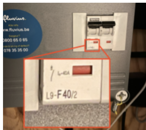
vb1: 2-polige automaat, 40A, 9,2kVA
