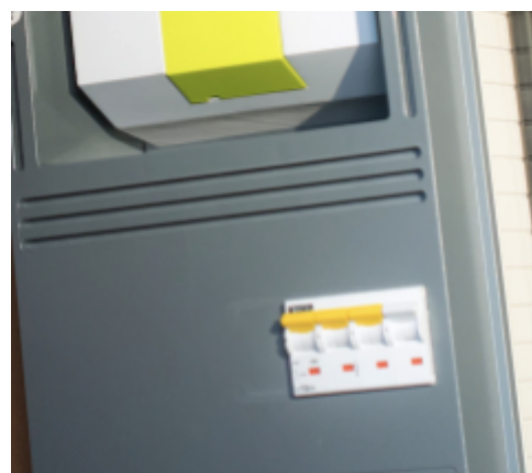
vb2: 4-polige netaansluiting, 25A, 17,3kVA
