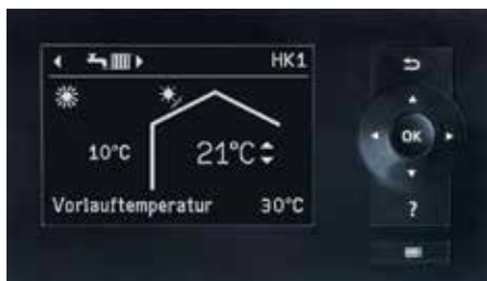
Affichage de la régulation de pompe à chaleur Vitotronic 200
